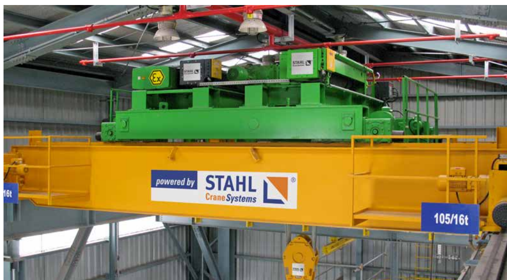
Lanové kladkostroje v nevybušném provedení s pomocným zdvihem ve dvojitém provedení pomáhají při údržbě kompresorů v zařízení pro zkapařňování vodíku.
